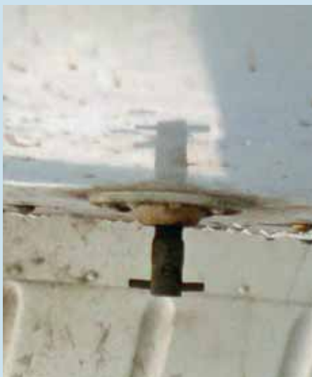
Se till att dräneringsventilen tätar efter dränering.
